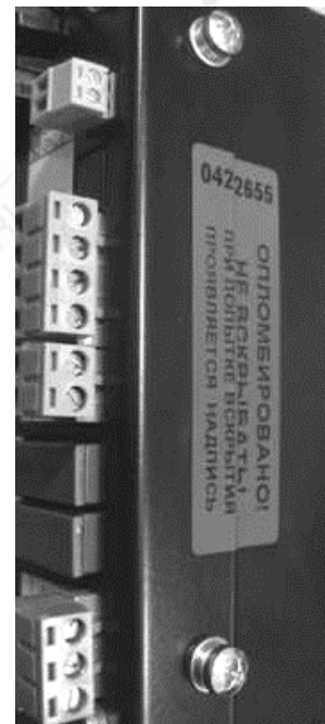
Рис.4. Пломбировка корпуса блока управления
