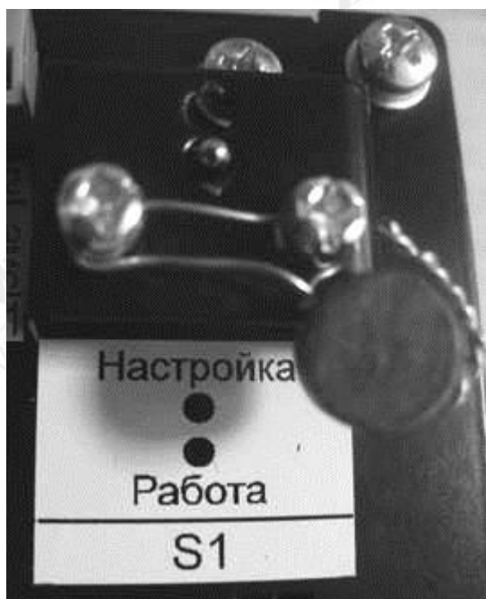
Рис.3. Пломбировка тумблера «Настройка/Работа» блока управления
