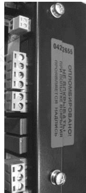
Рис.4. Пломбировка корпуса блока управления
