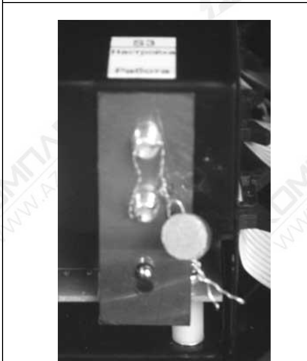
Рис.3. Пломбировка тумблера «Настройка/Работа» блока управления
