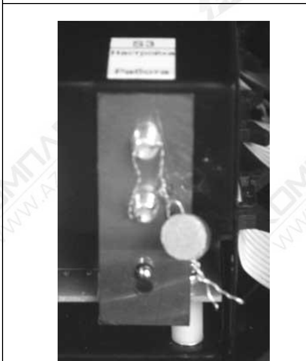
Рис.3. Пломбировка тумблера «Настройка/Работа» блока управления
